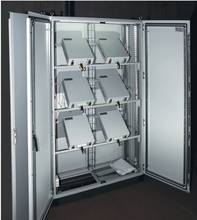
Стойки со сканерами температуры и давления
