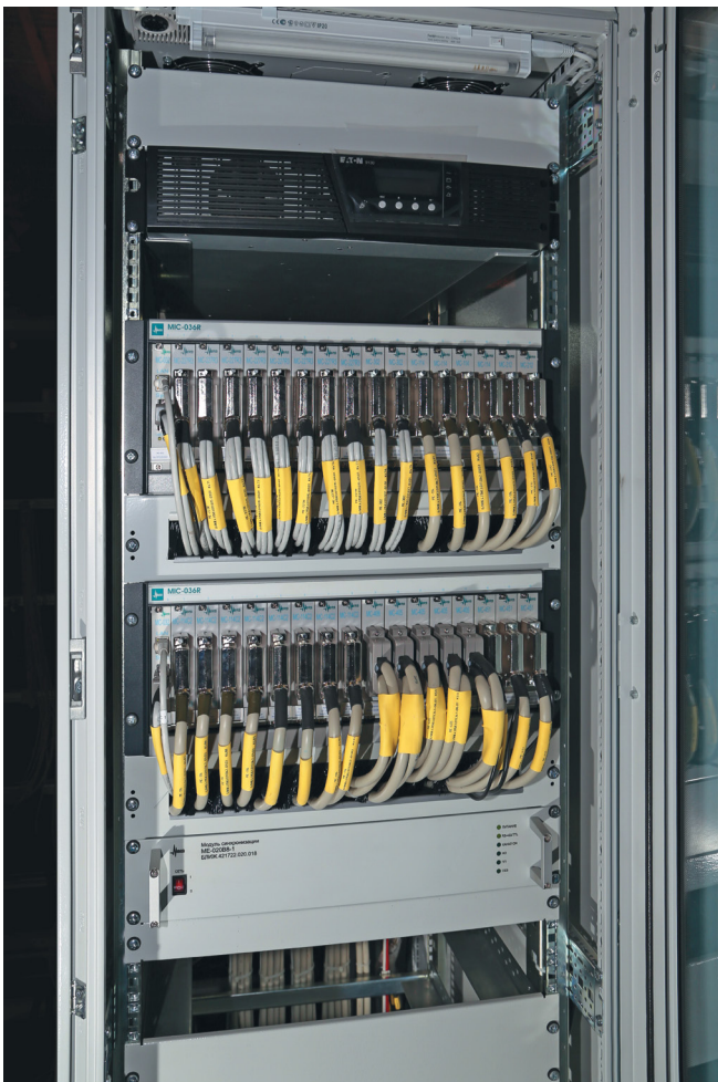
Приборная стойка общесистемных каналов
