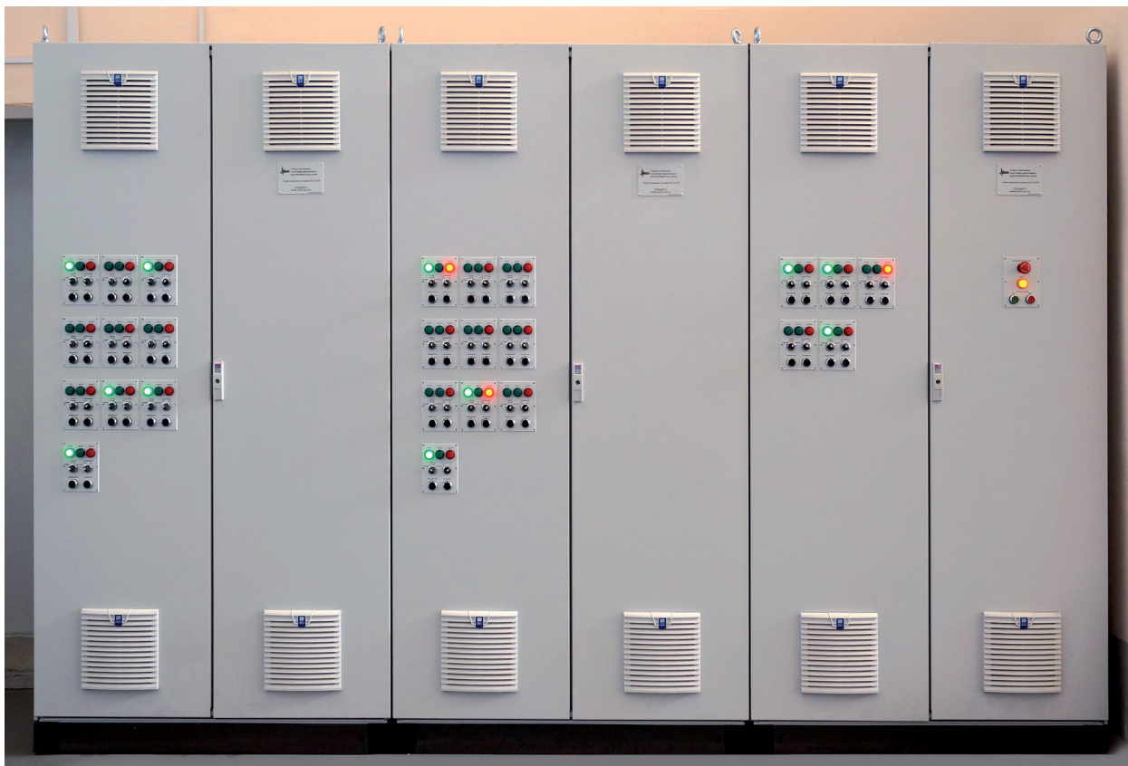
Шкафы силового управления
