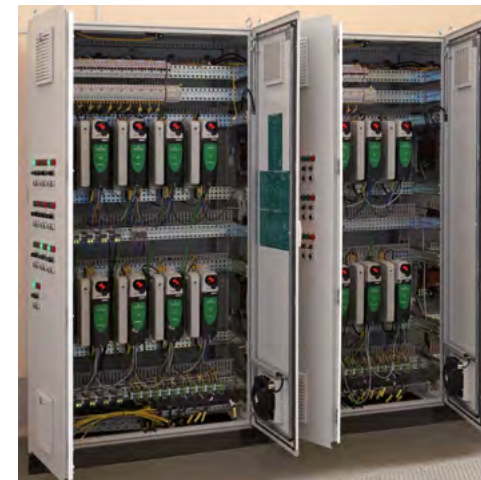
Шкафы силового управления
